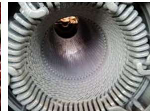
Rys.10. Dosztynienie prętów fazowych generatora
