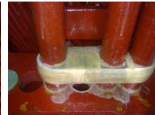
Rys.6. Dosztynienie szyn prądowych generatora
