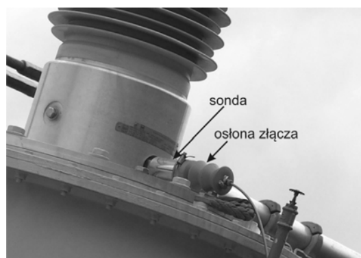
Rys.2. Sonda zainstalowana w gnieździe pomiarowym
