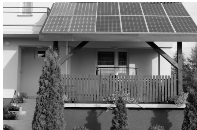
Zdjęcie 1. Zdjęcie przedstawia zastosowany układ generatorów PV jako zadaszenie tarasu.
