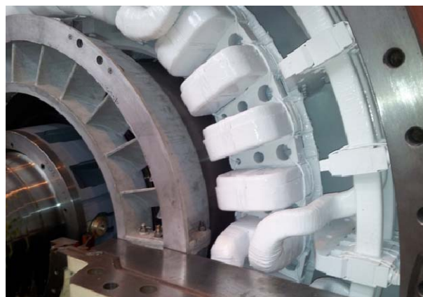
Rys.13. Widok kierownicy z tylnymi łopatkami kierowniczymi (turbogenerators TWW-200-2)
