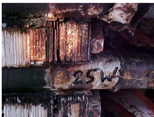
Rys.27. Widok uszkodzonych zębów pakietów skrajnych rdzenia stojana (turbogenerator TWW-200-2A)
