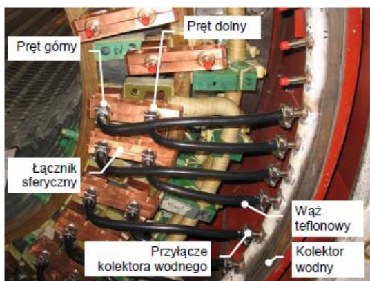
Rys.20. Widok połączeń czołowych uzwojenia stojana z łącznikami sferycznymi, węzami teflonowymi i kolektorem wodnym
