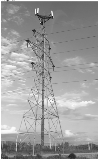
Rys.1. Przykład stacji bazowej GSM zainstalowanej na słupie wysokiego napięcia
