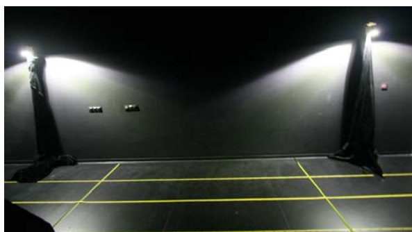
Rys. 5. Widok „czarnego” korytarza z zamontowanymi oprawami KWADRA SIDE firmy HYBRYD
