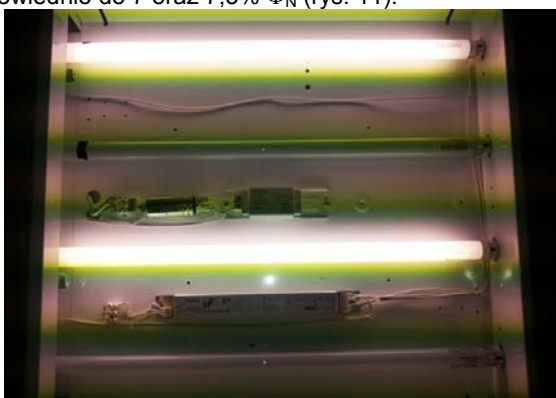
Rys. 12. Oprawa oświetleniowa z zamontowanymi lampami FL1 i FL2 oraz statecznikami KVG i EVG
