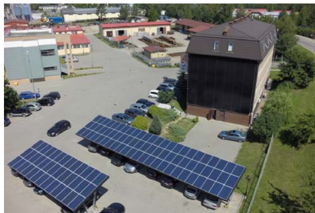
Rys. 1. Instalacja (1) - 111 paneli polikrystalicznych jako zadaszenie wiat parkingowych, instalacja (2) fasadowa, złożona z 63 paneli monokrystalicznych.
