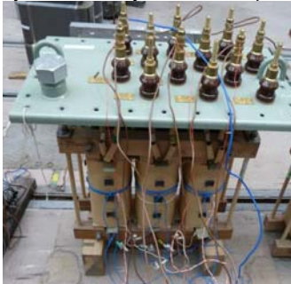
Rys.4. Widok transformatora badanego
