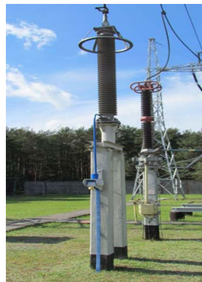
Rys.1 Widok ogranicznika przepięć 220 kV, wraz z podstawą izolacyjną i licznikiem zadziałań w połowie wysokości konstrukcji wsporczej
