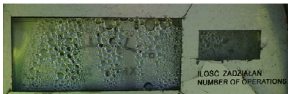
Rys.2 Wewnętrzne zawilgocenie wizjera liczydła w nieszczelnym liczniku zadziałań
