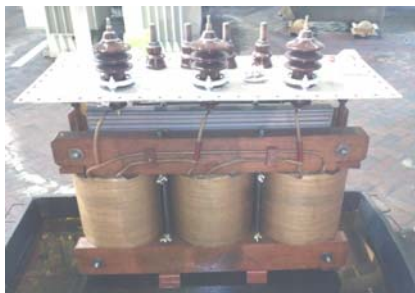
Rys.1. Fotografia części aktywnej badanego transformatora
