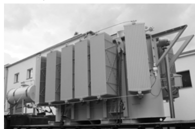
Rys.1. Obiekt badań – transformator sieciowy o mocy 16 MVA
