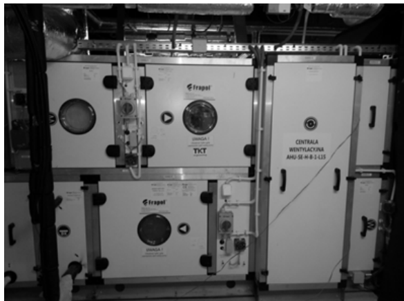
Rys. 5. Zdjęcia centrali wentylacyjnej z podłączonymi czujnikami
