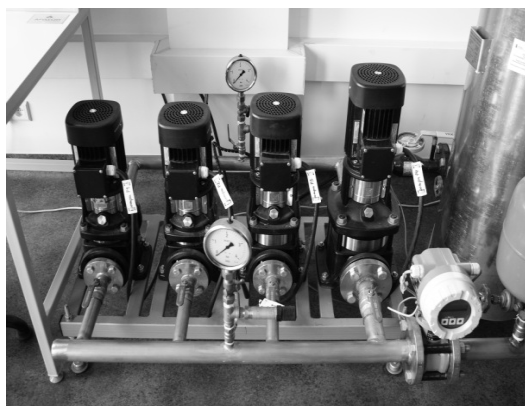
Rys.1. Widok zespołu pomp
