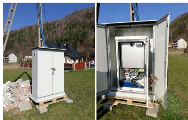
Rys. 9. Widok szafy szeregowego transformatora dodatkowego zlokalizowanej w miejscowości A
