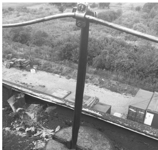
Rys. 2. Obiekt uszkodzony w wyniku nie zachowania wymaganych odstępów separacyjnych i niekontrolowanych przeskoków iskrowych od instalacji odgromowej [1]
