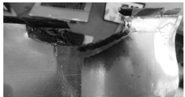
Rys.9. Uszkodzenie transformatora na skutek zwarcia między zwojowego
