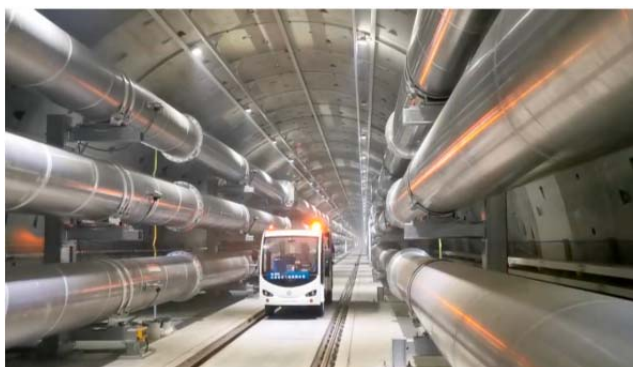
Rys.5. Tunel pod rzeką Jangcy z dwutorową linią Suzhou-Nantong na napięcie 1000 kV [13]
