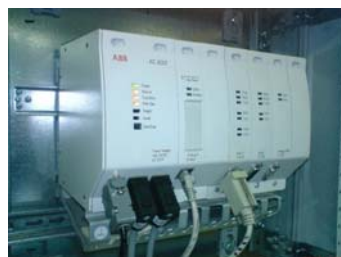
Rys.4. Widok stacji procesowej AC800F (oprac. wł.)
