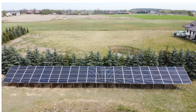
Rys. 3. Monitorowana mikro elektrownia fotowoltaiczna
