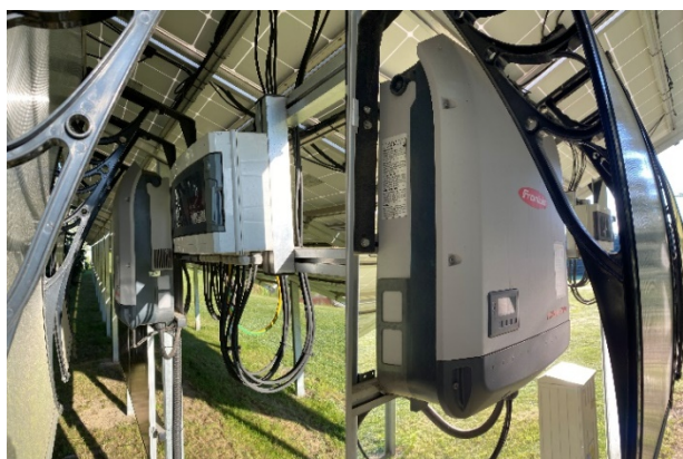
Rys. 4. Falownik i osprzęt monitorowanej mikro elektrowni fotowoltaicznej
