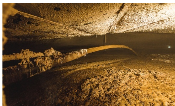
Rys.3. Widok dyszy zraszającej biogazowni z mieszaniem hydraulicznym w trakcie pracy
