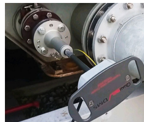
Rys.2. Widok ogólny anteny prętowej typu Qualitrol CMD01591 zainstalowanej w zaworze spustowym oleju transformatora.
