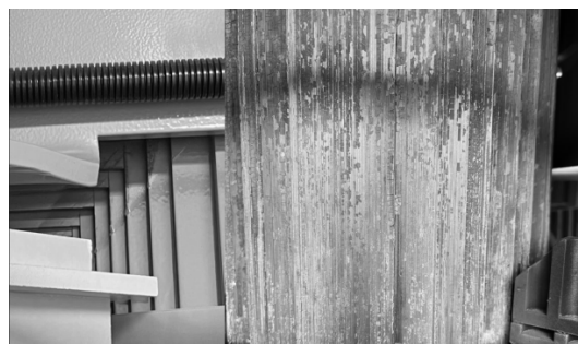
Rys.4. Widok przykładowych problemów w ocenie stanu rdzenia transformatora
