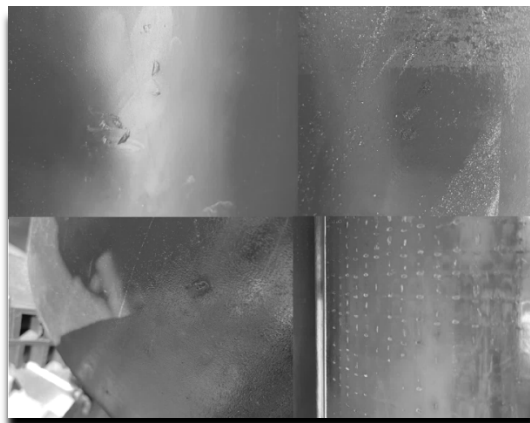
Rys.3. Widok przykładowych problemów w ocenie cewek SN transformatorów
