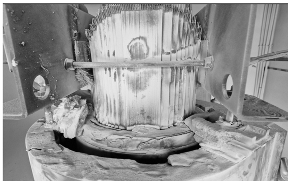
Rys.2. Widok transformatora po awarii po pięciu dniach od zainstalowania
