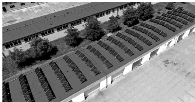
Rys. 3. Widok rozmieszczenia modułów PV – Instalacja C
