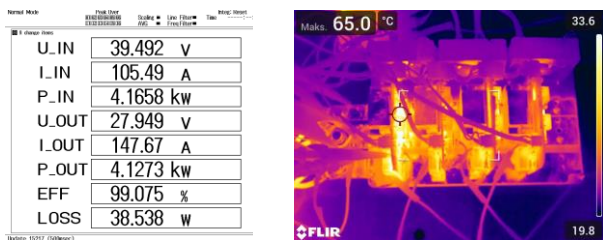
Rys.12. Wyniki badań eksperymentalnych czterogłęziowego przekształtnika GaN przy maksymalnym obciążeniu, realizowanym w testach laboratoryjnych: a) wynik z analizatora mocy, b) zdjęcie przekształtnika zrobione kamerą termowizyjną
